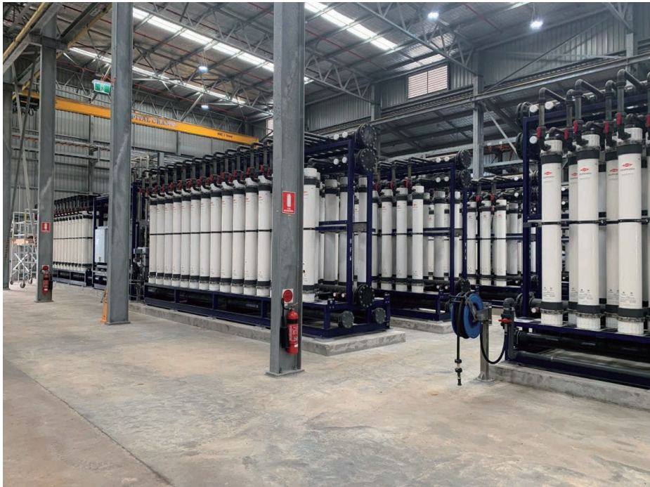
照片 1 超滤预处理
